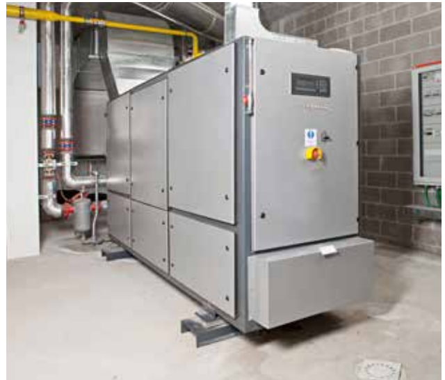
Cogeneratore Vitobloc 200 EM-140/207 presso le piscine Villa D'Almè (BG)
