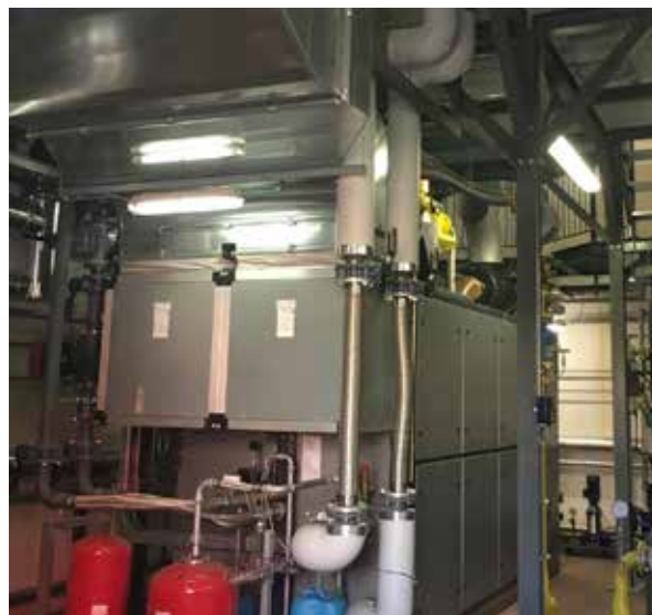
Cogeneratore Vitobloc 200-EM 530/660 presso Maina Panettoni Spa
