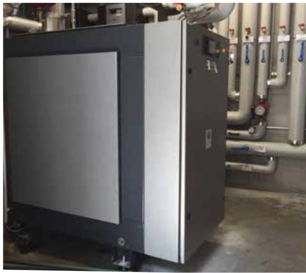
Cogeneratore Vitobloc 200 EM6/15 presso l'Hotel Edenselva
